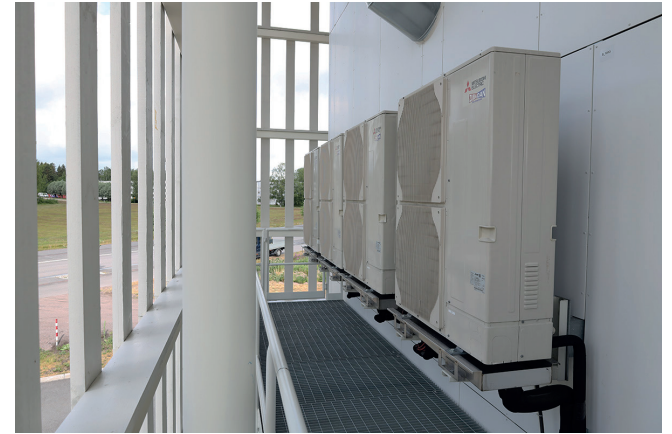
Nikkilän sydämen päiväkotii, 4 x Large Hydrobox + Mitsubishi Electric PUHZ-SHW230YKA
